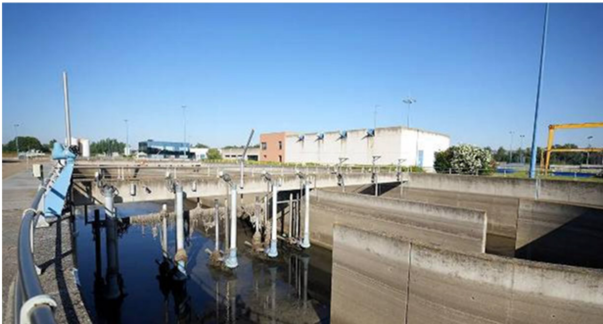
Figura 9 Tanque de tormenta.
