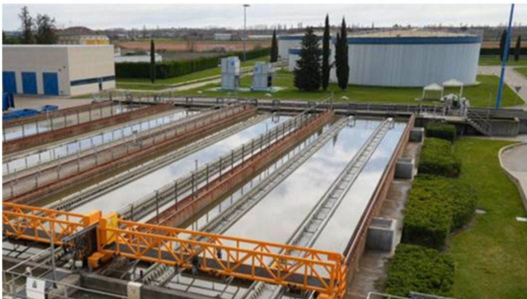
Figura 2 EDAR de Valladolid
